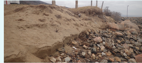
État de l'érosion des berges en avril 2024 SOURCE : Comité ZIP Saguenay-Charlevoix, 2024
