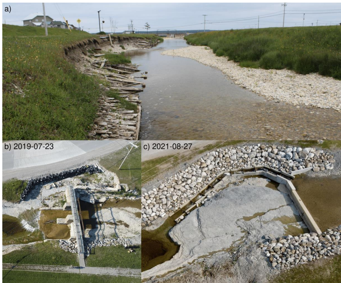
Figure 10. Dégradations du canal Saint-Georges : a) en berge concave au niveau du coude (350 m) en 2019 ; et dans la zone du barrage X2092719 démantelé (475 m) b) le 23 juillet 2019 ; c) le 27 août 2021 (source photographique : Gaëtan Laprise).
