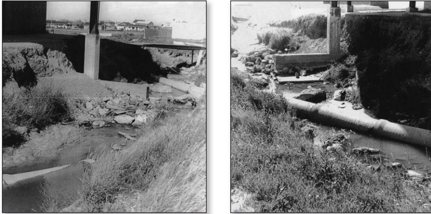
Figure 4 - Photos datant des années 1970 et illustrant les dommages causés par les crues dans le ruisseau Renouf près de l'école de secondaire (avant le détournement). Source : archives de la ville de Trois-Pistoles.
