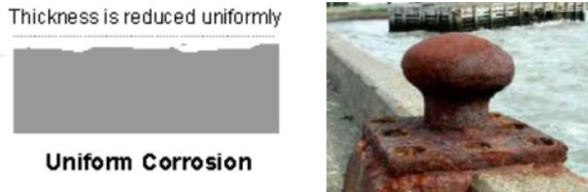
Figure 4. (a) Représentation schématique de la corrosion uniforme et (b) un acier vieillissant [15].
